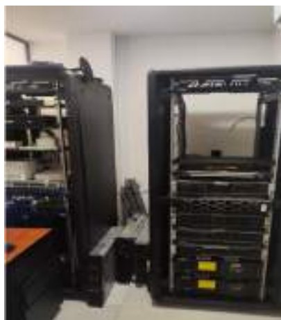
Figura 1. Ubicación de Racks
